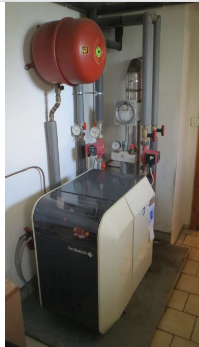
KG - De Ditrach Heizanlage 199
