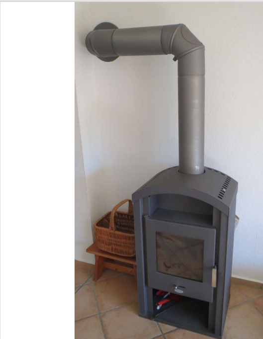
EG Wohnen Kaminofen 6KW
