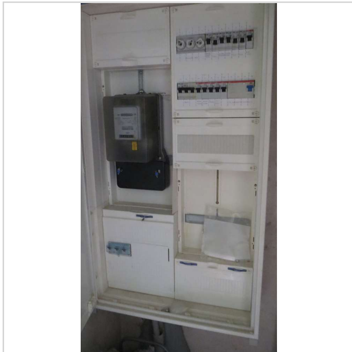
Abgang KG Energie UV
