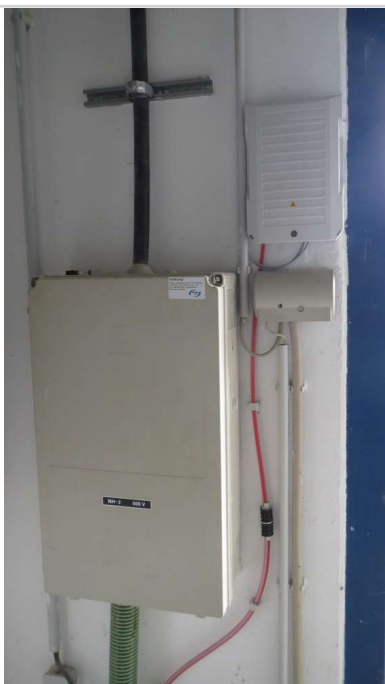
E- HA- Glasfaser telekom
