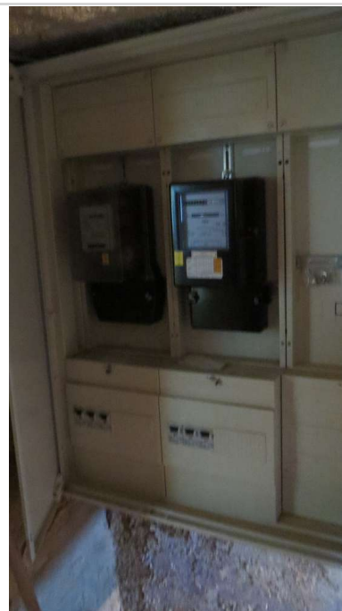
E- Zähler- Sicherung
